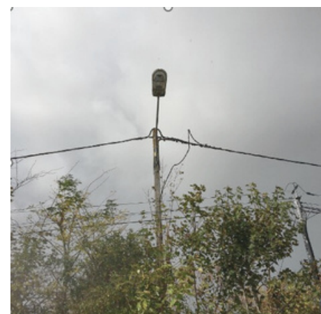
Câble décroché, intervention Enedis, Chemin de Nicot
